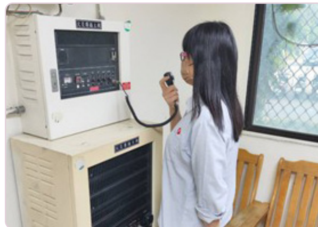
通報班，確認火災，通報全廠區
