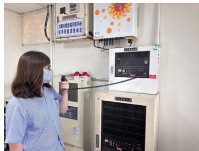
▲ 通報班，確認火災，通報全廠區
